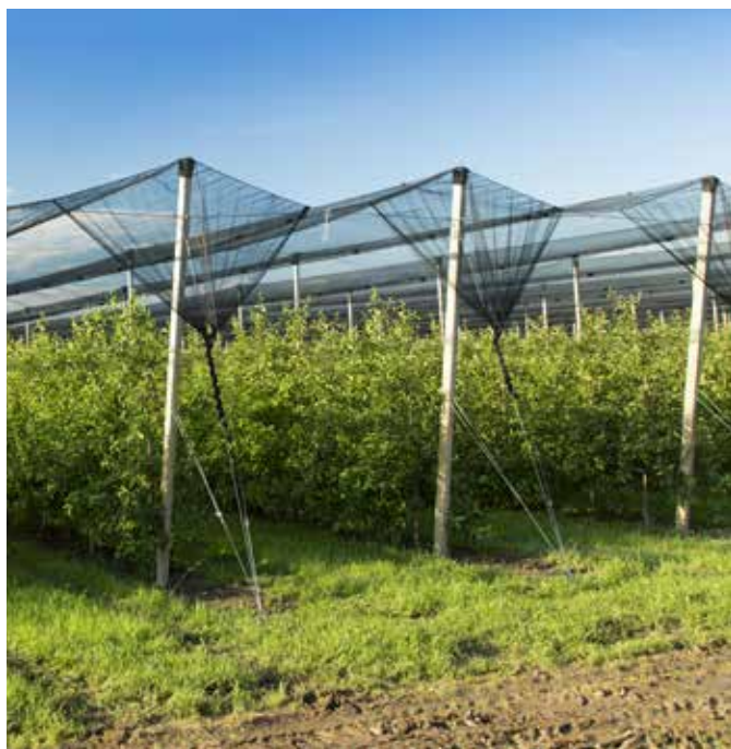
DPAK - Instalado em postes de betão em forro de loop e com nó de estrangulamento
