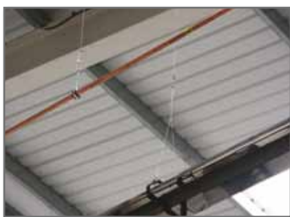
Pannelli radianti a gas
